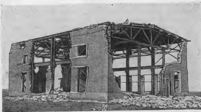
Рис. 108. Промышленное здание с металлическим каркасом, находившееся в зоне полного разрушения: а — до взрыва; б — после взрыва
